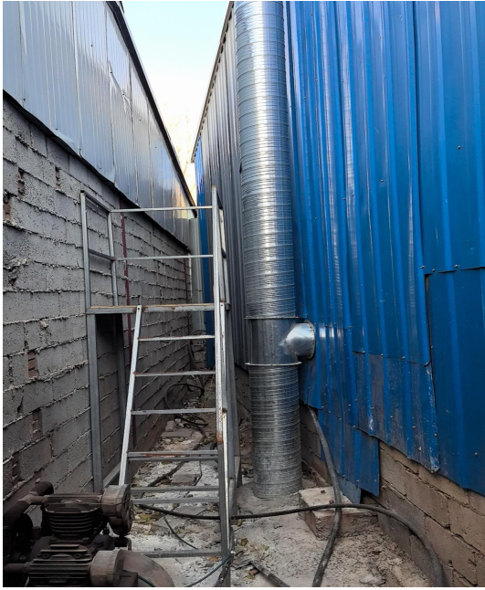
附图 4 废气治理设施
